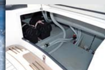
En los cofres más grandes se han instalado además diferentes servicios, como baterías y bombas de sentina en el de popa.
